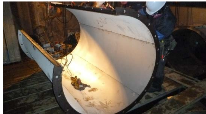
【説明7】分解搬入型 \Phi 1200mm 導管 5分割された \Phi 1200mm 導管の組立状況
